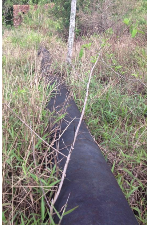
Figura 6 – Conduto Forçado de Aço
