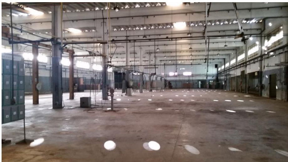
Figura 8 – Foto interna demonstrando a rede interna de ar comprimido.
