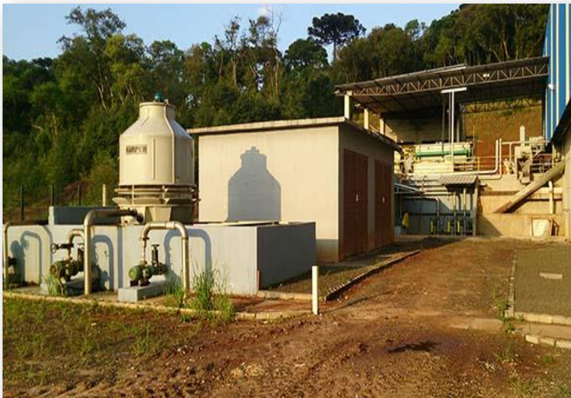
Fotografia 2 – Tratamento de Água
