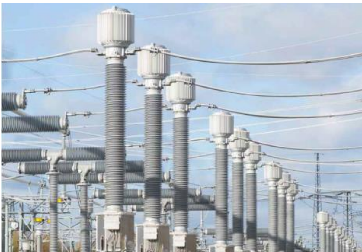
Figura 20: Transformadores de corrente do tipo convencional.
