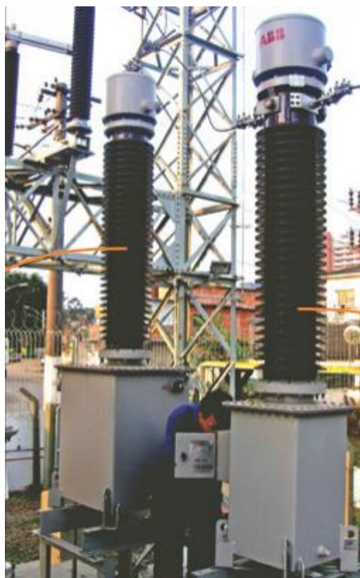
Figura 21: Transformadores de potencial do tipo convencional.
