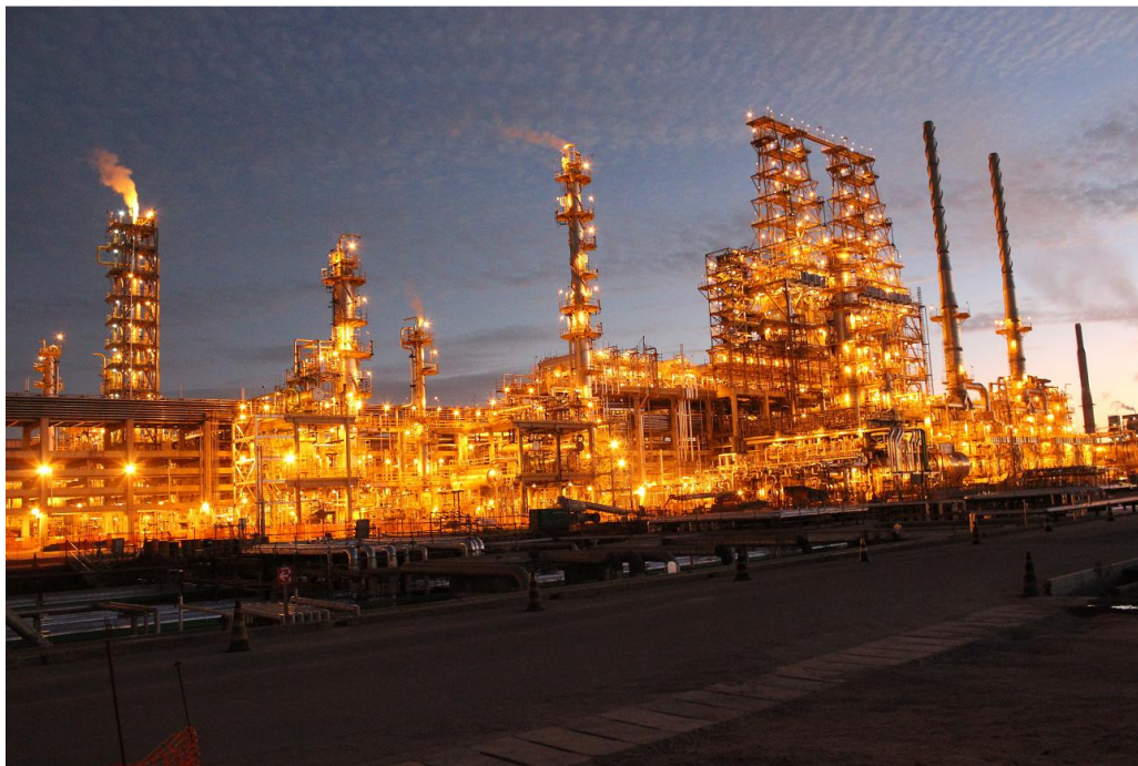
Unidade de Coqueamento Retardado na Refinaria Getúlio Vargas – Araucária – Paraná 2012
