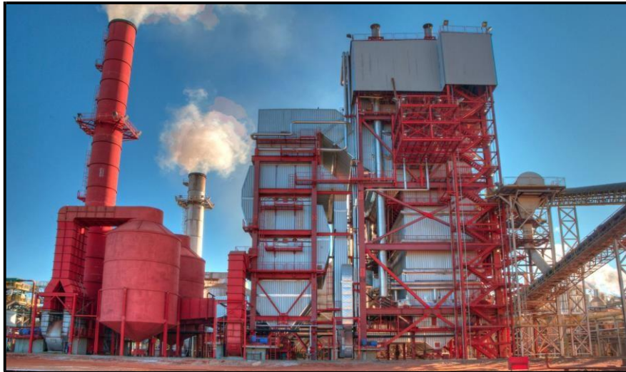
Figura 2. Visão externa caldeira em termelétrica.
