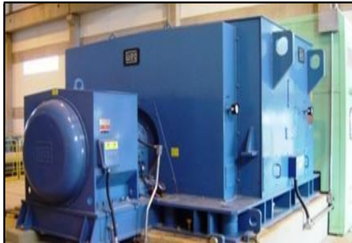
Figura 10. Gerador Síncrono: visão externa.
