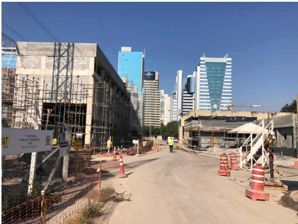
Figura 17 – Instalações da PBTE na SE Bandeirantes Fonte: Foto - 03/07/2019
