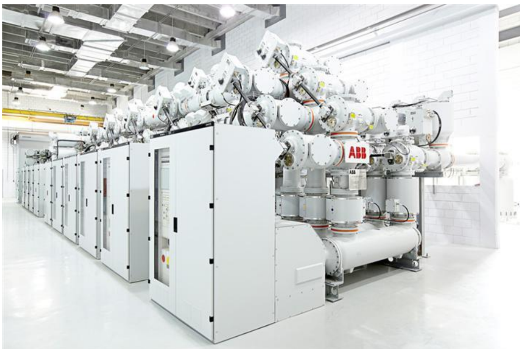
Figura 16 – Gas Insulated Substation – GIS Fonte: Catálogo ABB
