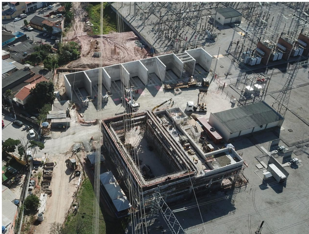
Figura 18 – Instalações da PBTE na SE Piratinga II Fonte: Foto com Drone - 03/07/2019
