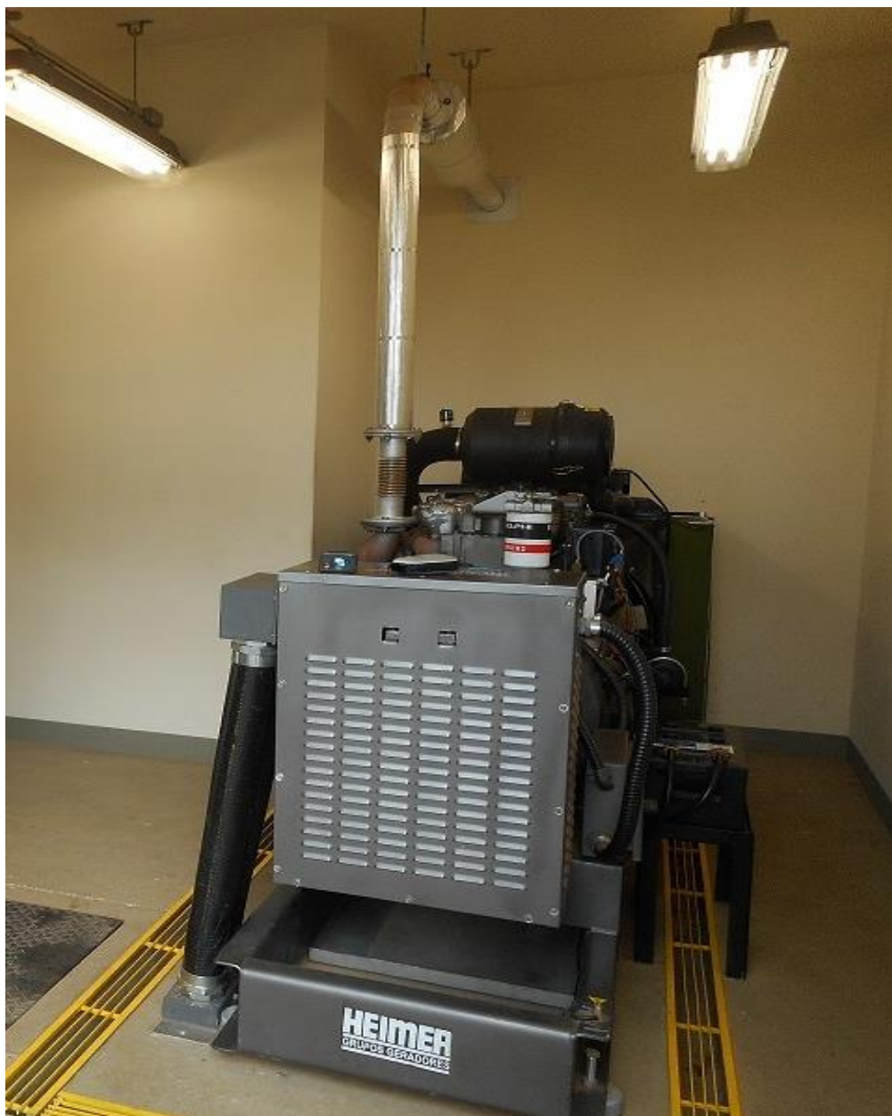
Figura 18: GMG Subestação Maringá 230 kV Fonte: Própria (2018).
