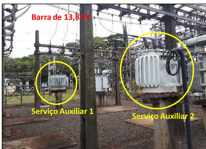
Figura 6: Serviços Auxiliares da Subestação Maringá 230 kV Fonte: Própria (2018).
