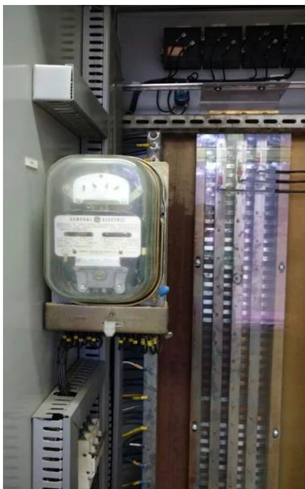
Figura 21: Medidor de energia dos Serviços Auxiliares Subestação Maringá 230 kV Fonte: Própria (2018).
