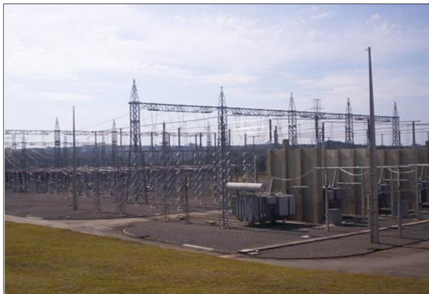
Figura 5: Subestação Bateias 525 kV – Copel GeT Fonte: Própria (2008).
