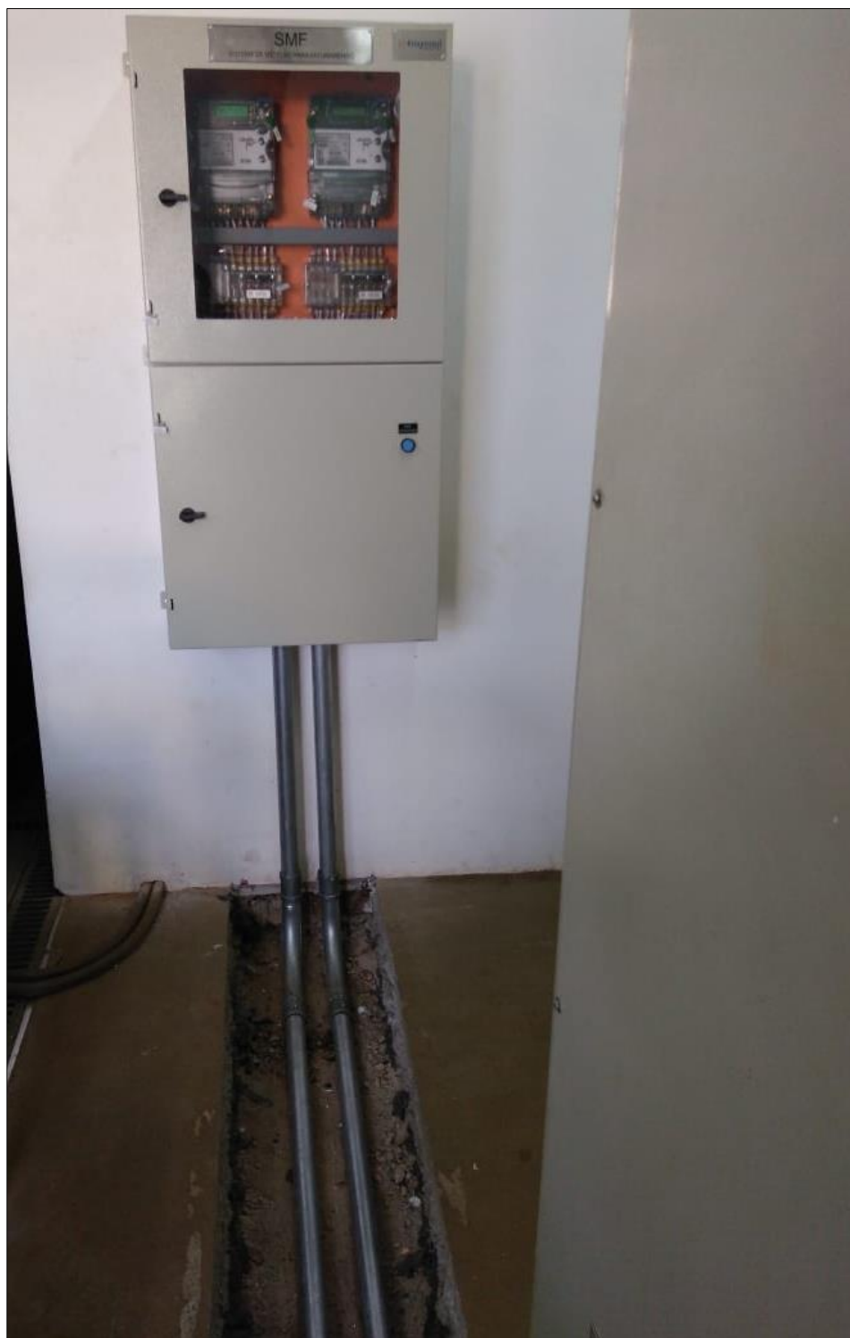
Figura 27: SMF Instalado na SEMGA Fonte: Própria (2018).
