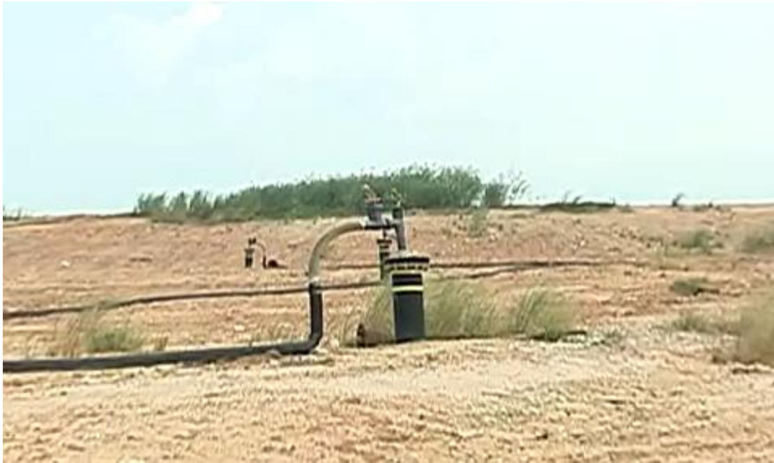
Figura 9 – Saída das tubulações para captação do Biogás Fonte: Globo News, 2013.
